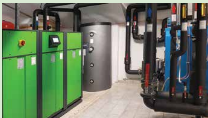
Prenovljena kotlovnica OŠ Korena
